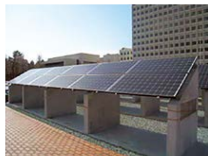
山形県庁の太陽光発電設備
