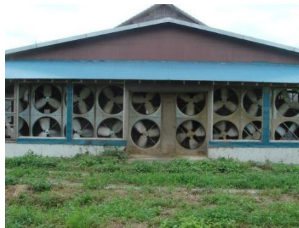
換気扇、送風機の稼働
