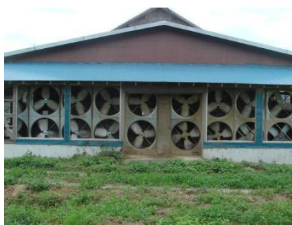
換気扇、送風機の稼働
