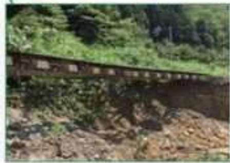
盛土流出 (伊佐領～羽前沼沢間)
