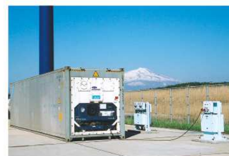
冷凍(リーファー)コンテナとリーファーコンセント
