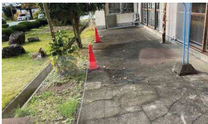
(本館 剥がれた軒天)
