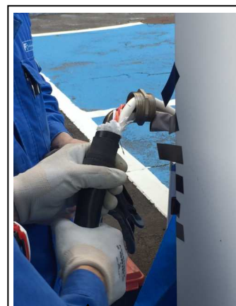
業者による保守 点検（年1回）
