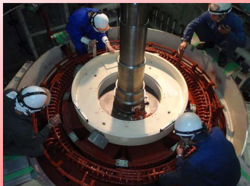
水車発電機オーバーホール(発電機)
