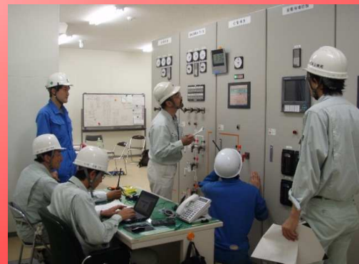
水力発電所運転試験(配電盤室)
