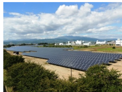
山形浄化センター
