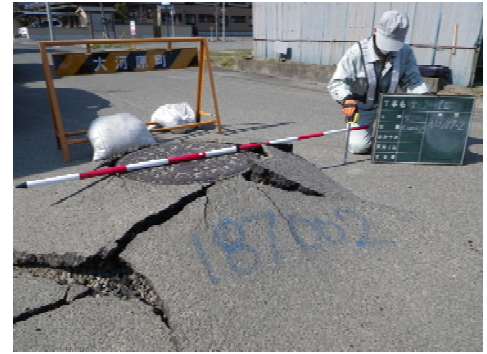
宮城県大河原町におけるマンホールの隆起
