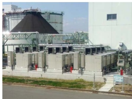
山形浄化センター
