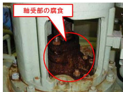
ポンプ設備の腐食
