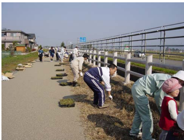
住民参加の維持管理活動につながる直営施工 (水路安全策設置と植栽作業：因幡堰地区)
