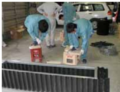
測量成果を基に設計を行い、高校生を中心に魚道の部材加工を実施（H22.5.14）
