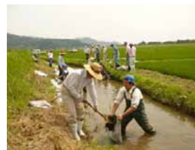
排水路の増水により水田魚道が洗掘等の被害を受け、地域住民と高校生協働で補強作業を実施
