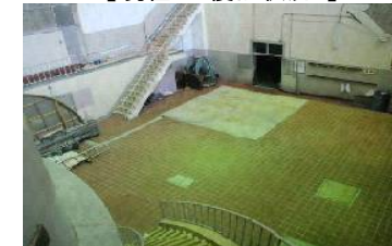
【現在の復旧状況】
