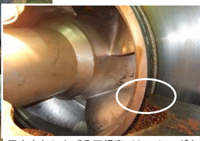
用水をおし上げる羽根車（ケーシングとの回転部の磨耗進行）
