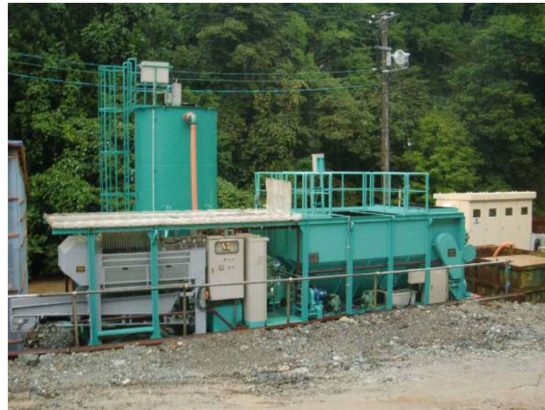
施工中の仮設備(トンネル)工事のプラント写真です。これは30m 3 /hの設備ですが、流水型ダム工事では、100m 3 /hの設備となります。
