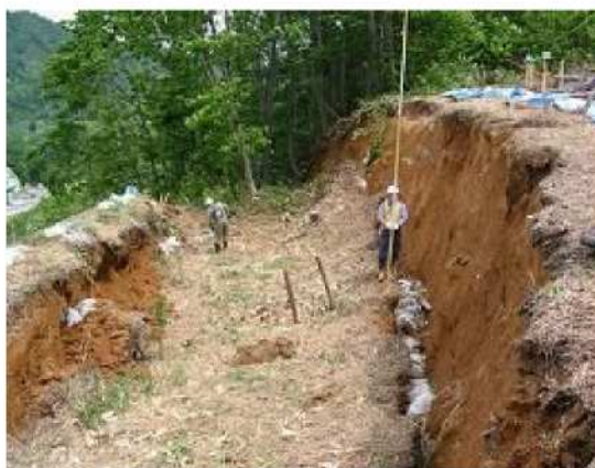
月山地区の地すべり(H16.5) ＜国道112号が6日間通行止め＞
