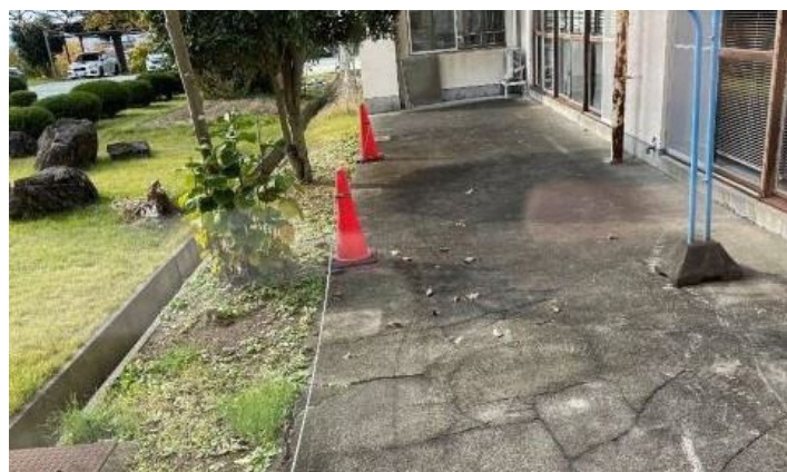
（本館 剥がれた軒天）
