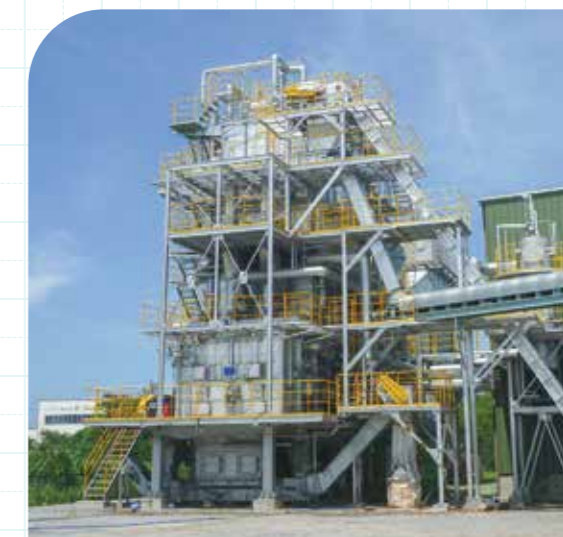
バイオマス発電所
