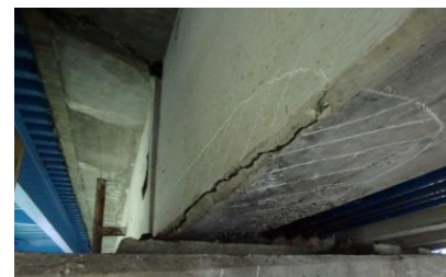
上部工損傷状況(ひび割れ)
