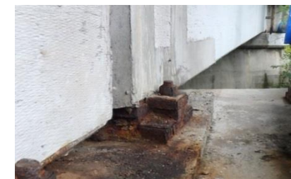
支承損傷状況(腐食)
