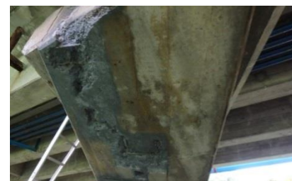
下部工損傷状況(鉄筋露出)
