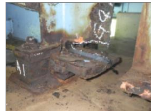
▲主桁・支承部の腐食状況
