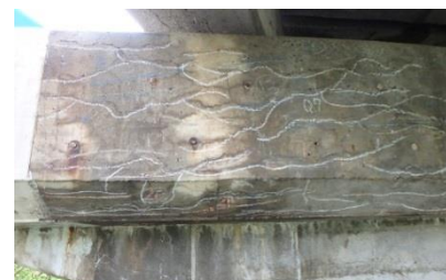
下部工損傷状況(ひび割れ)
