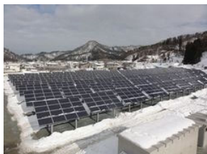
県営太陽光発電所
