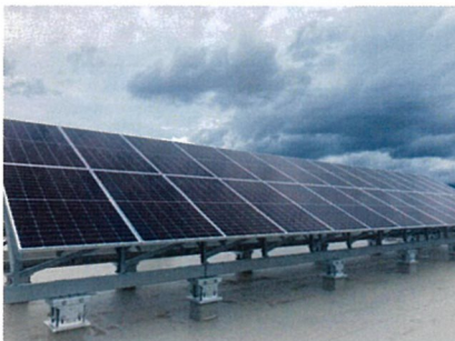
太陽光発電システム
