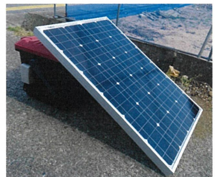
独立電源システム
