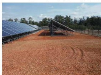
太陽光発電所 (鶴岡市)
