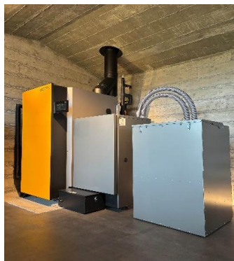
バイオマスボイラー
