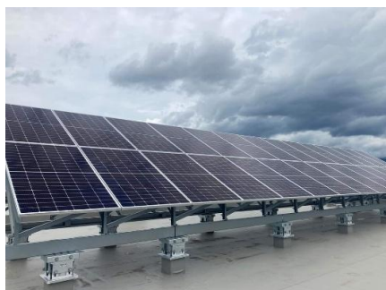
太陽光発電システム
