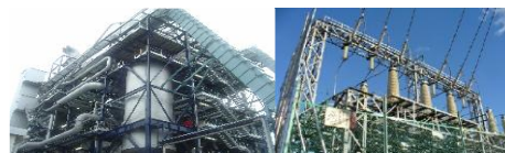
木質バイオマス発電
