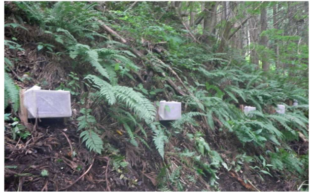
図 土砂受け箱設置状況写真
