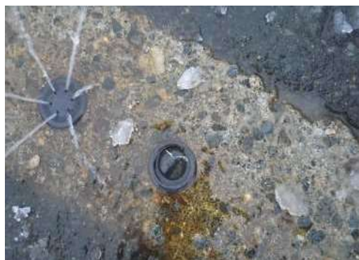
消雪パイプの破損状況
