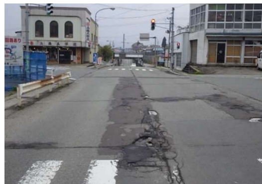
無散水消雪（放熱管）の破損状況
