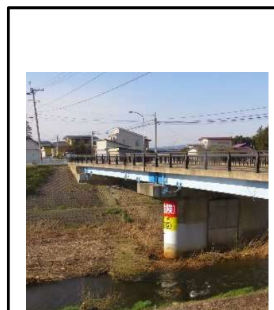
量水標設置状況
