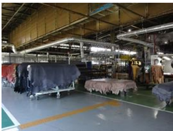
空調からダクトで各作業者へ
