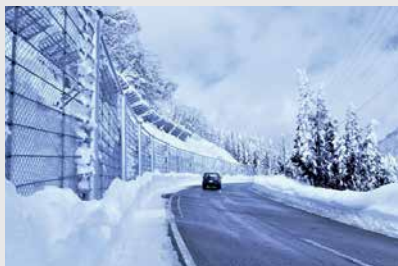
雪崩予防対策（吊柵＋せり出し防止柵）
