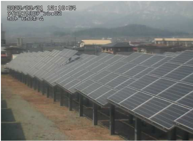
令和5年3月31日 12:10 太陽光発電所の状況
