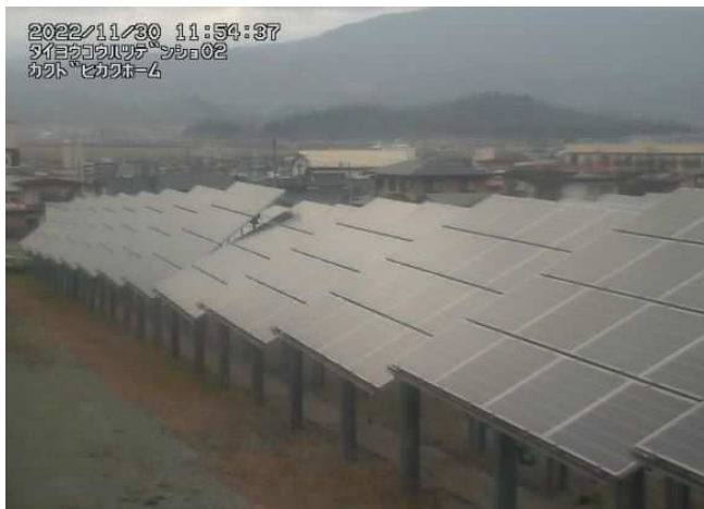
令和4年11月30日 11:54 太陽光発電所の状況
