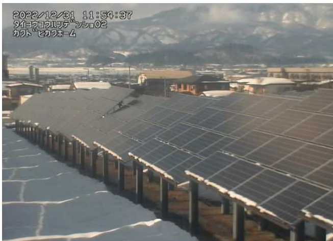
令和4年12月31日 11:54 太陽光発電所の状況
