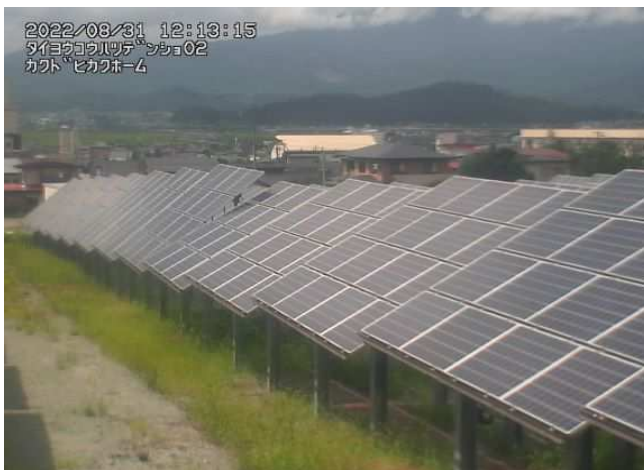
令和4年8月31日 12:13 太陽光発電所の状況
