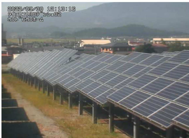
令和4年9月30日 12:13 太陽光発電所の状況
