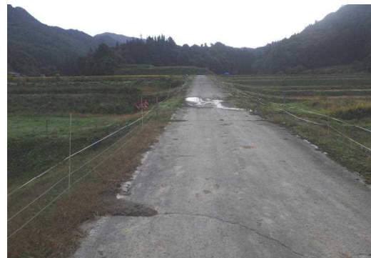
【本件事故現場の状況】
