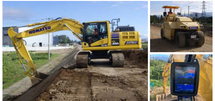
ICT活用工事の施工例 (3次元データを活用した盛土工事)
