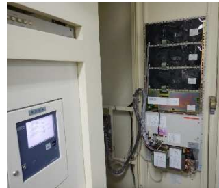
中央病院 照明制御盤 (現行)
