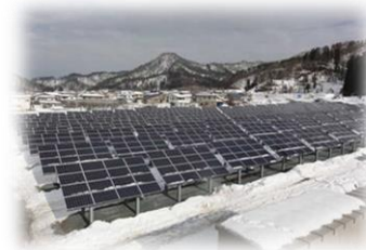
太陽光発電所
