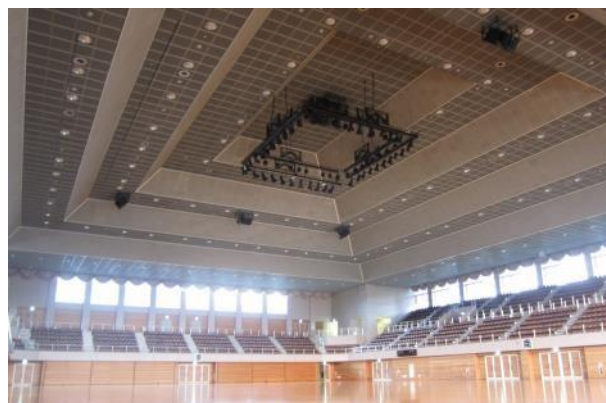
▲山形県総合運動公園総合体育館の照明設備更新
