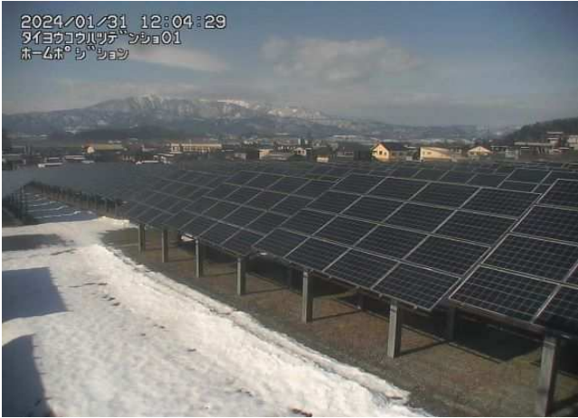
令和6年1月31日 12:04 太陽光発電所の状況
