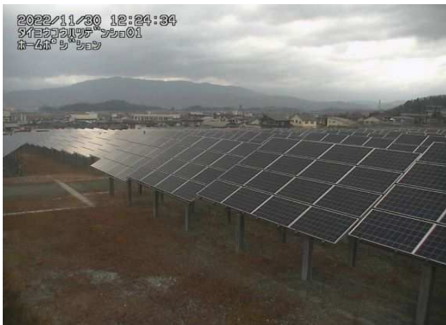
令和5年11月30日 12:24 太陽光発電所の状況
