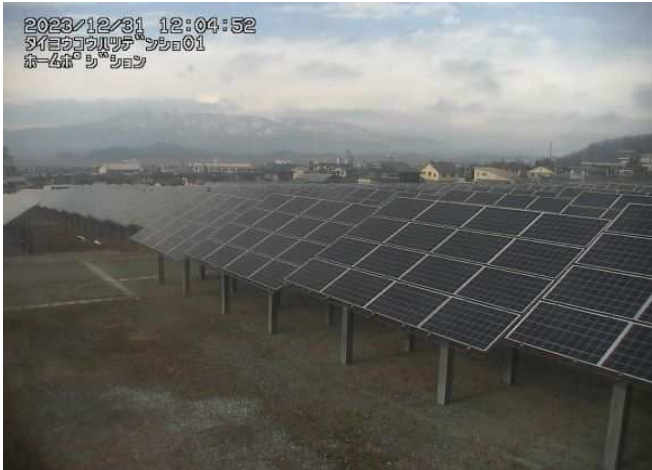
令和5年12月31日 12:04 太陽光発電所の状況
