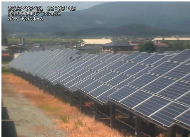
令和5年8月31日 12:06 太陽光発電所の状況
