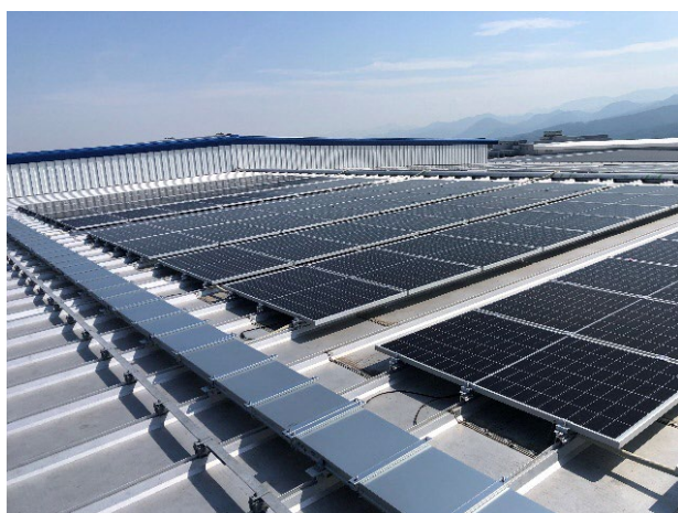
自家消費型太陽光発電設備の導入
