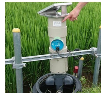
給排水遠隔制御装置の設置
