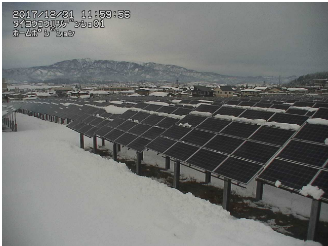
平成29年12月31日 12:00 太陽光発電所の状況
