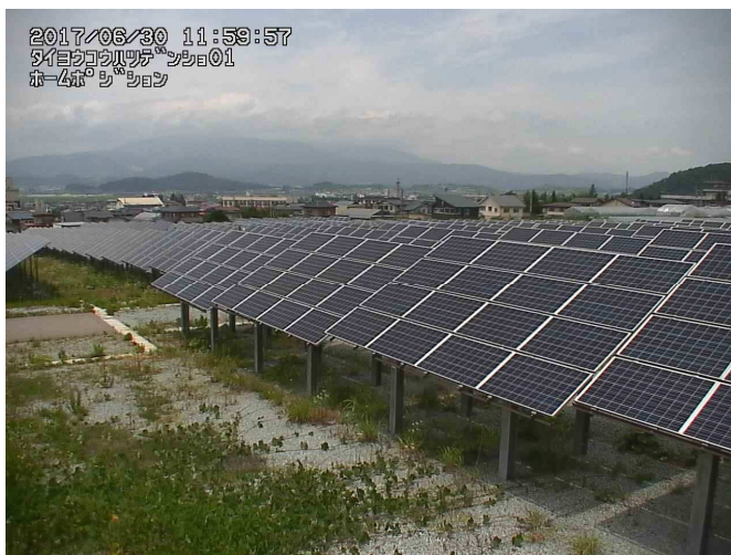
平成29年6月30日 12:00 太陽光発電所の状況
