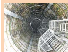
しゅうせいせい 集水井
