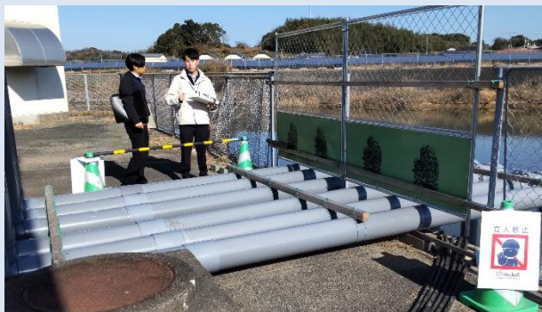
上天草市での仮設ポンプ確認
