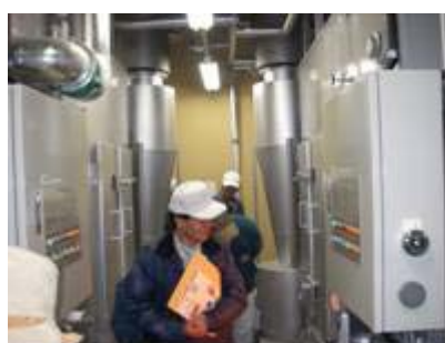
ペレットボイラー室
