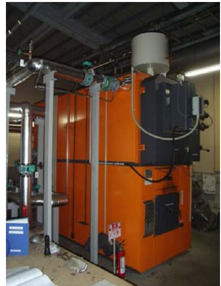
【木質バイオマスボイラー】
