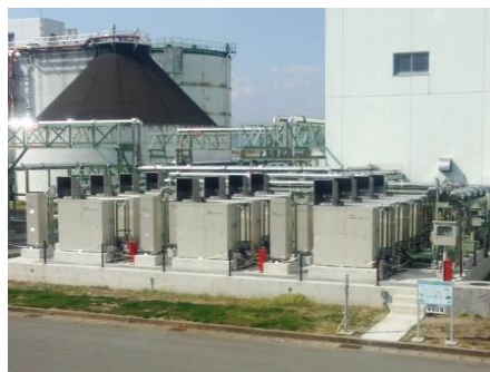
山形浄化センター
