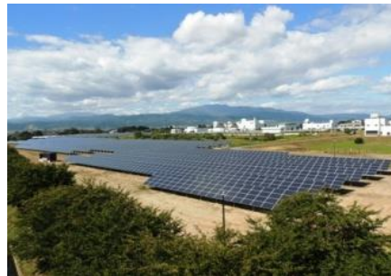
山形浄化センター
