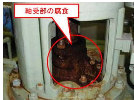
ポンプ設備の腐食
